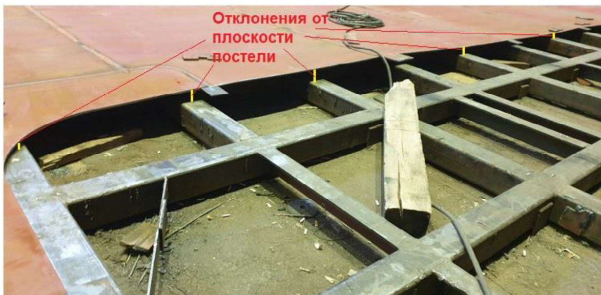
Рис. 2. Отклонение полотнища от плоскости постели из-за сварочных деформаций
